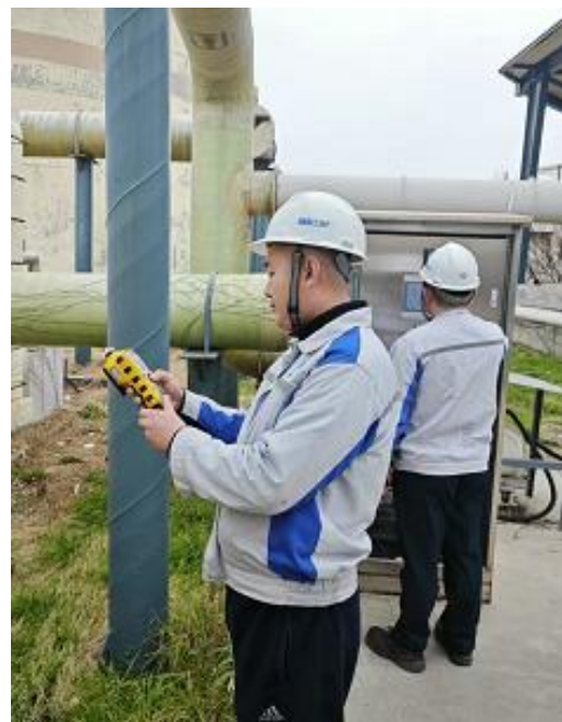
图 6：抢险组排除除臭设备故障
